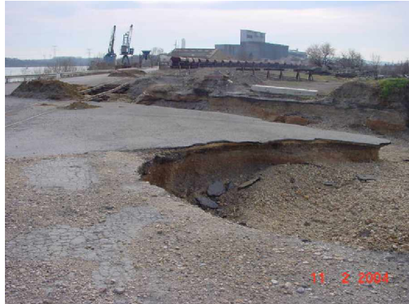
Brèche au niveau du port Source : CETE Méditerranée
