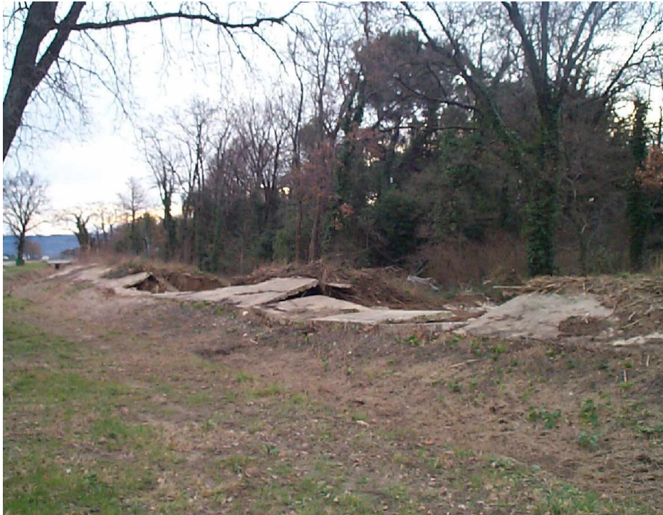
Déversoir endommagé à Pierrelatte Source : Subdivision DDE 26
