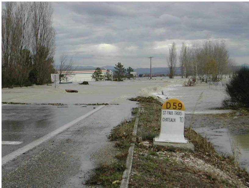
RD 59 inondée et endommagée Source : Subdivision DDE 26
