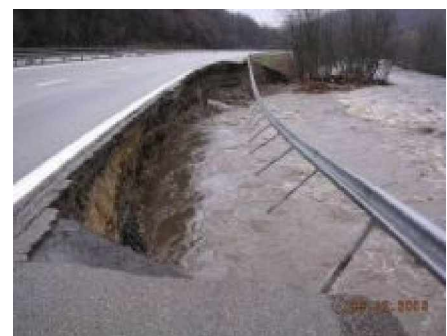
Erosion de l'A 47. Source DDE 42
