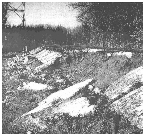
Dégâts dans la digue du Château (île de la Barthelasse) en 2003. Source : DDAF 84
