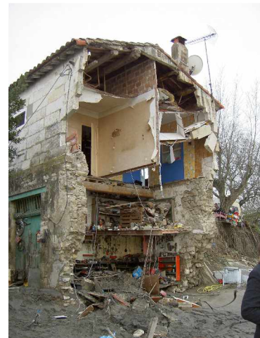
Maison de garde digue détruite. Source SYMADREM
