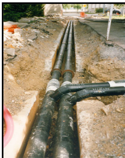
Photo 11 : Canalisation de chauffage urbain technique Wanner (source Compagnie Générale des Eaux)
